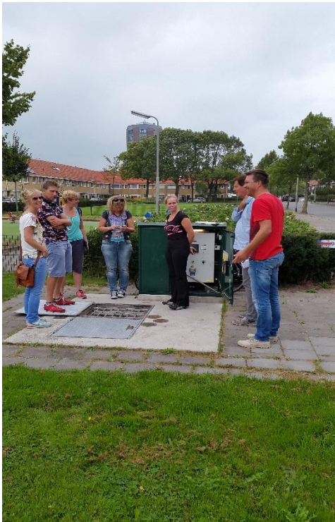
Gemaal aan de Pasteurweg
